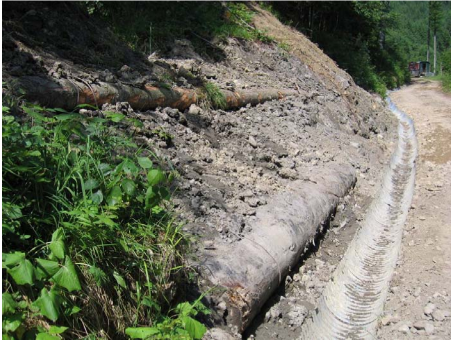
Halbschale und Hangsicherung vor dem Unwetter von August 05, 24.06.2005
