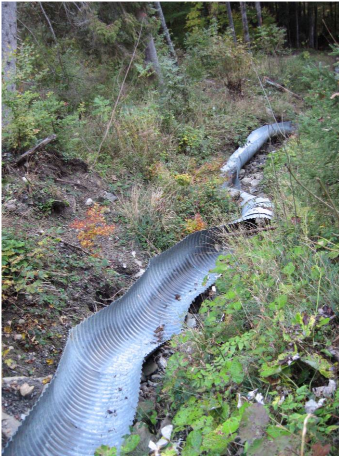
Zerstörte Halbschale in Eichetschwand 17.10.2007
