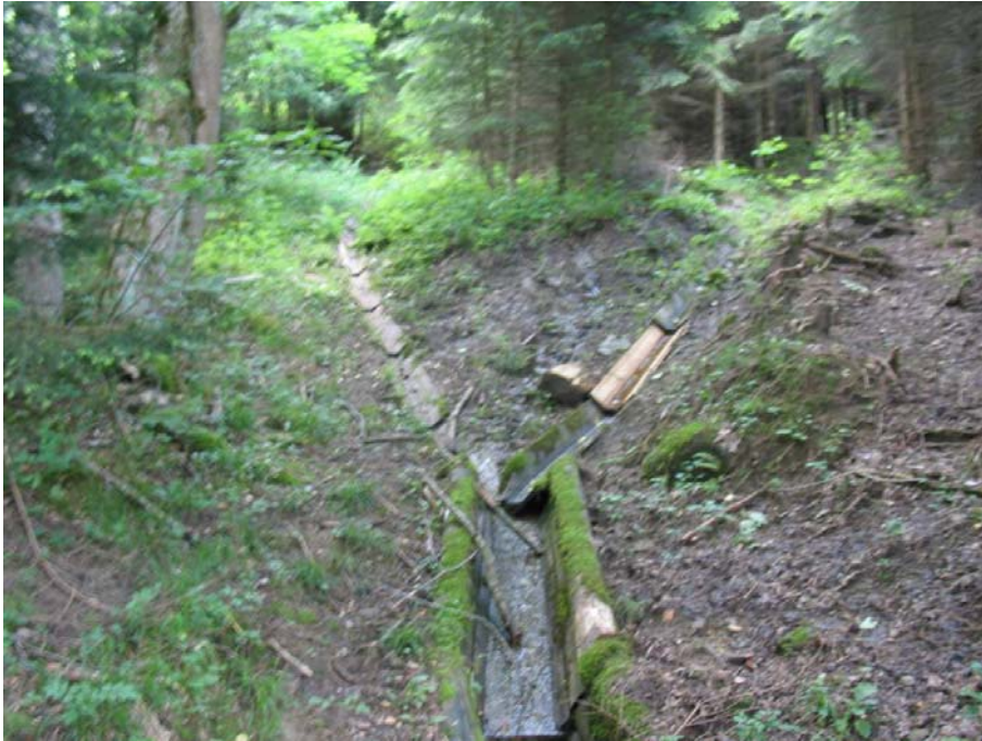
Zustand der V-Graben vor den Ausführung der Massnahmen, Eichetschwand 25.06.2004
