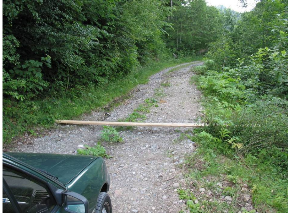
Die durch Rutschung, teilweise gesenkte und beschädigte Strasse in der Eichetschwand, 25.06.2004
