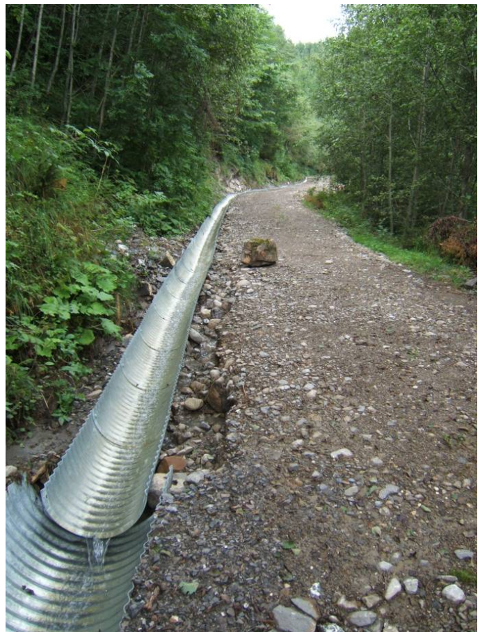
Halbschalen entlang der Strasse nach dem Unwetter von August 05, 26.08.2005
