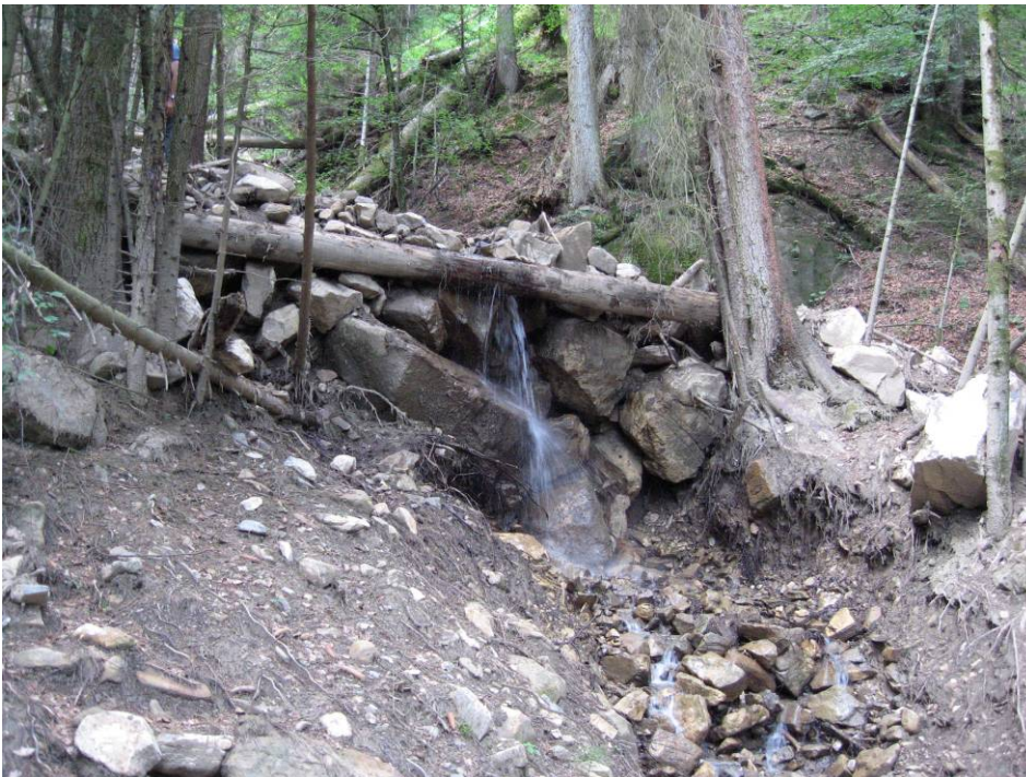
Abbildung 69: Verklauung und Murgangspuren im Schnellengraben.
